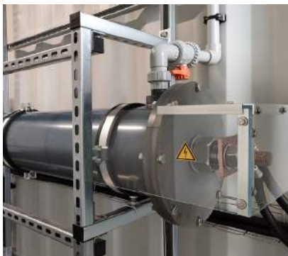
Unité de dépollution d'un effluent ammoniacal pour Reuse 2 m 3 /h (verrière du groupe Saint-Gobain à Carentan, Manche).
