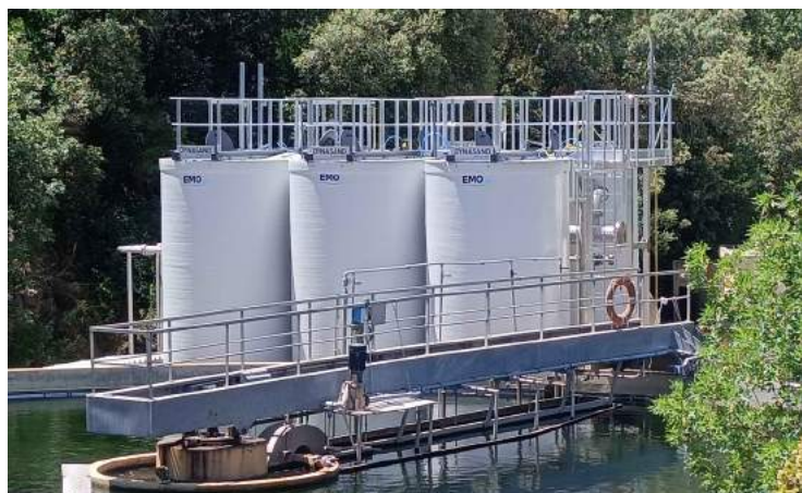
Traitement tertiaire par FILTRE À SABLE avant rejet en milieu naturel et/ou REUT
