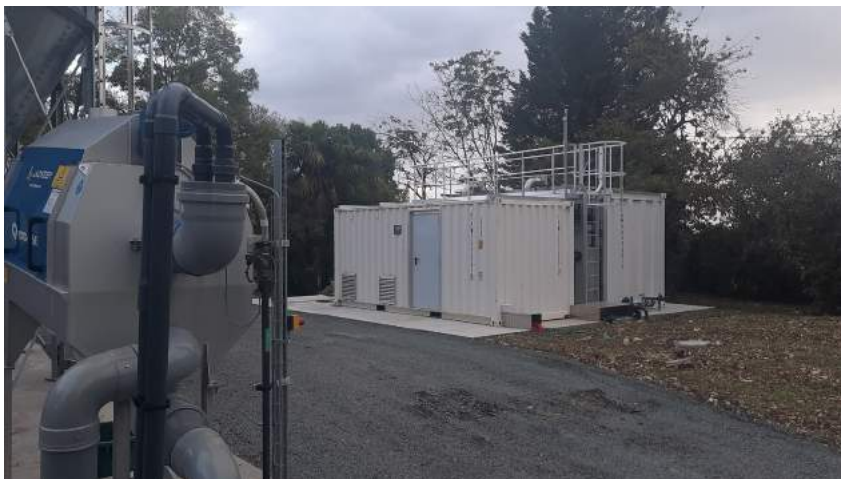
Solution conteneurisée de traitement des eaux usées dans une distillerie par Atlantique Industrie.
