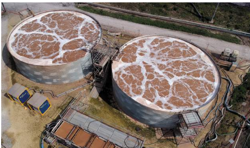
CTP environnement – Vue d'une installation de traitement biologique des effluents et clarification.
